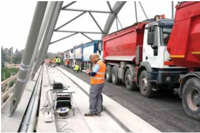
Fig. 25 - Fasi di collaudo
