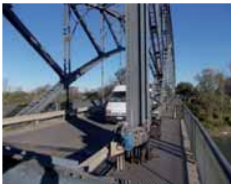
Fig. 33 - Montaggio vibrodina per eccitazione longitudinale (Y)
