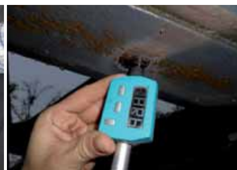
Fig. 12 - Verifica spessori e prove di durezza su pendini, arconi, diaframmi reticolari
