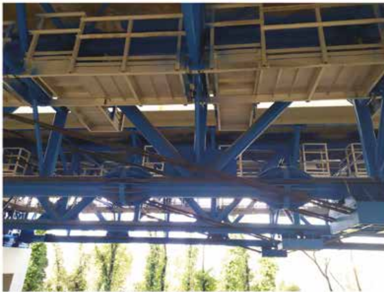
a) Sostituzione nodo danneggiato e precompressione esterna
