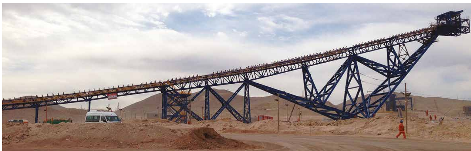
Fig. 1. | Impianti di movimentazione
