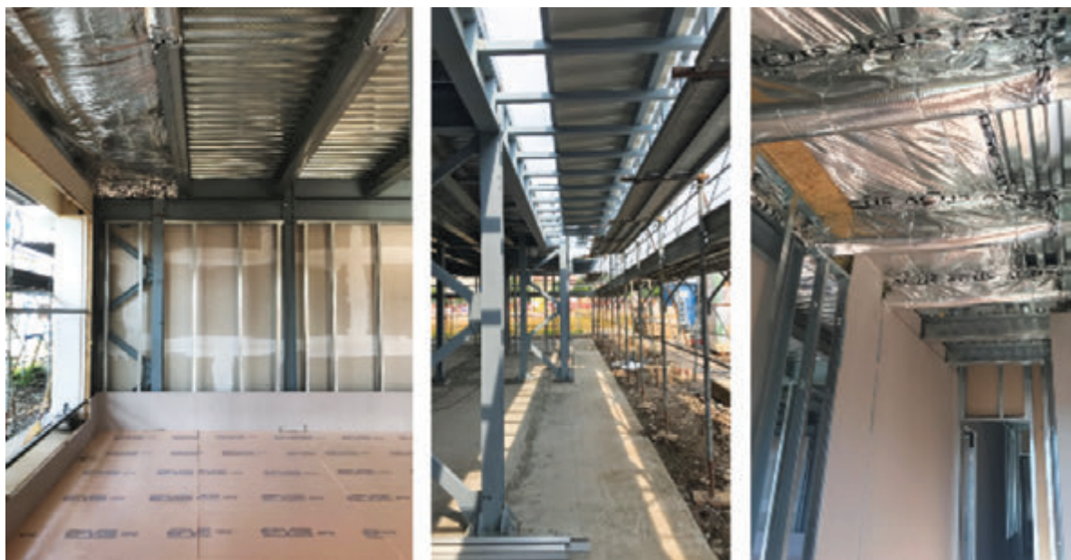
Fig. 12 | Immagini di cantiere delle fasi di assemblaggio del sistema S/R post modellazione BIM - Calusco d'Adda (BG) 2016/17
