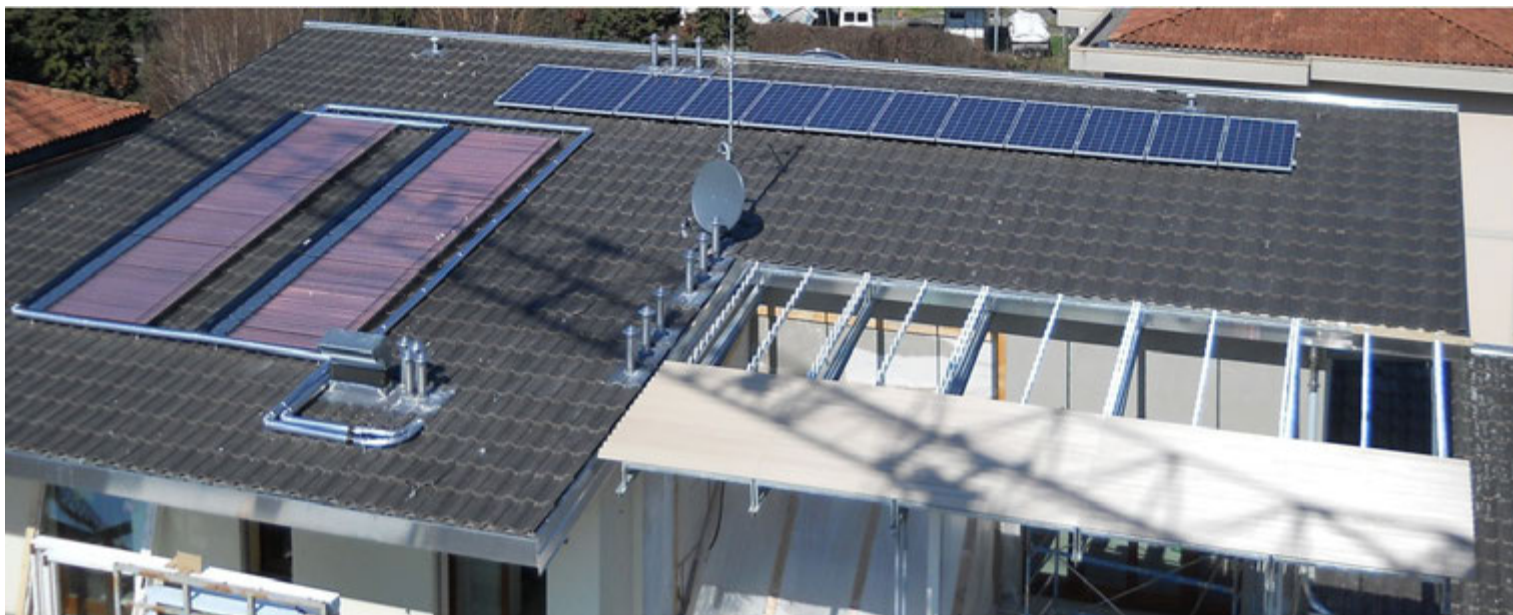
Fig. 20 | Fase di assemblaggio del manto di copertura degli impianti e dei sistemi oscuranti
