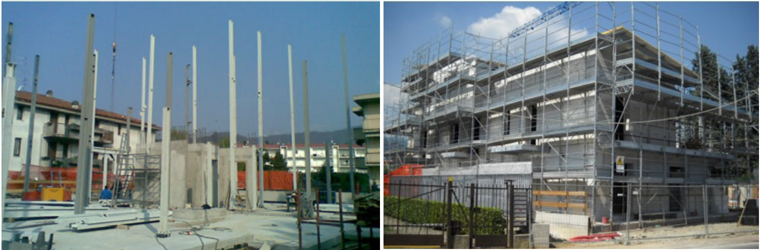
Fig. 17 | Fasi di assemblaggio delle carpenterie in acciaio e della pelle esterna in lastre fibro-cementizie
