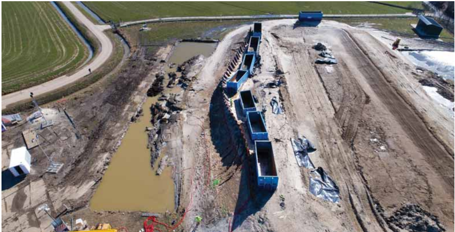
Fig. 8 | Fase di cedimento della diga blu
