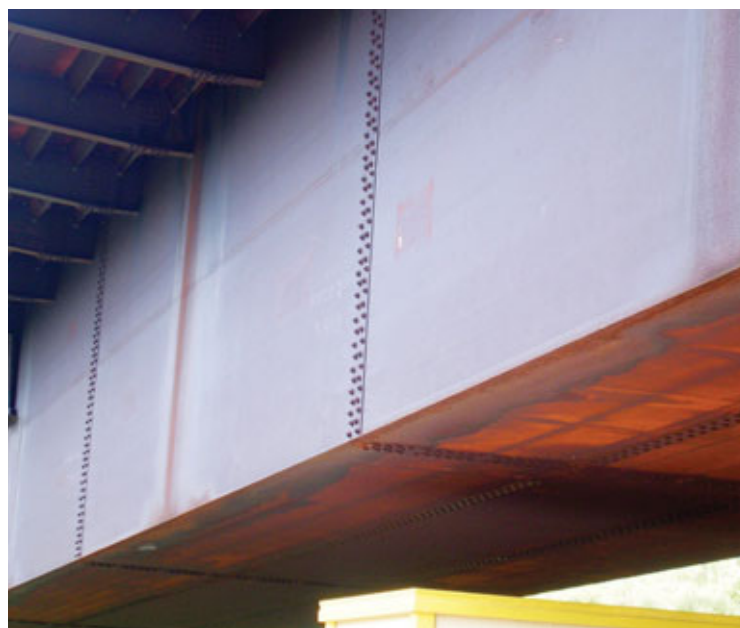
Fig. 4 - Viadotto Fragneto (SS95) prima della manutenzione
