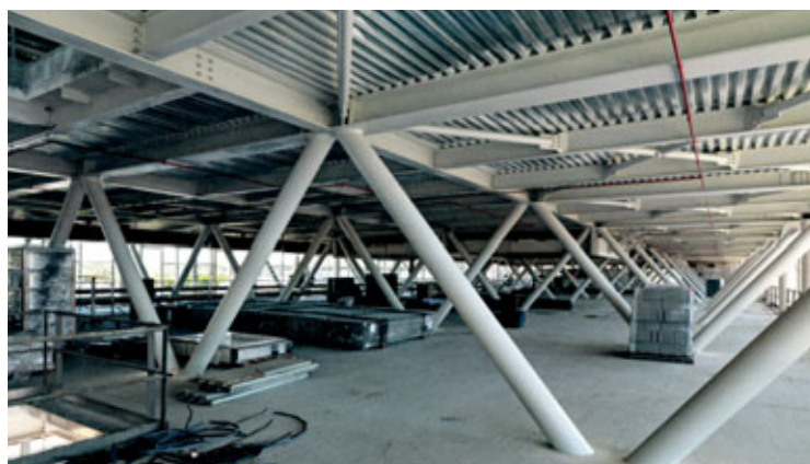
Fig. 5 - Mezzanino impiantistico © E.Cano
