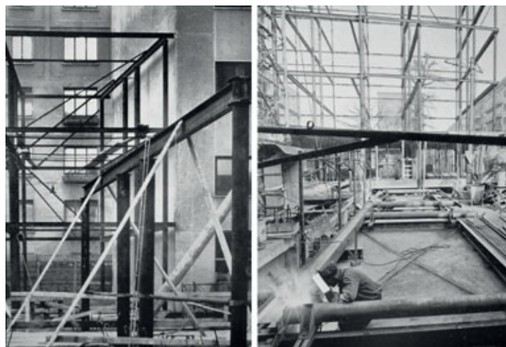
Fig. 12 – Progetto e costruzione della sede della Sidercomit (1958-1960): l'impiego "dell'intelaiatura di riscontro" per la fase di saldatura a piè d'opera (Fondazione Dalmine).
