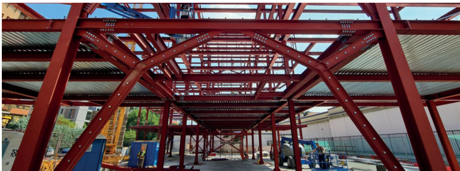
Fig. 33. Struttura a telaio in acciaio con controventamenti completata e posa dei solai in lamiera grecata. © Carpenteria S.A.C.I.F. Srl
