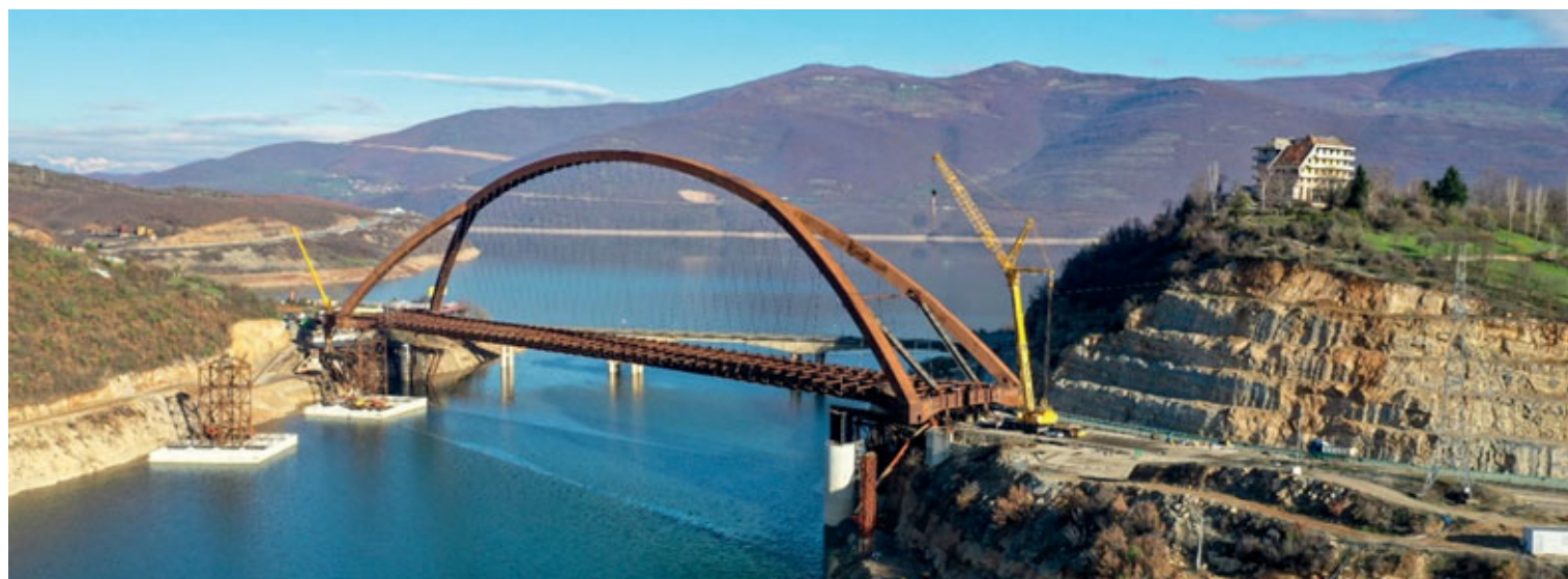
Fig. 8 - Ponte varato prima del calaggio di 10 m | Bridge launched before the 10m [32.8 ft] cast
