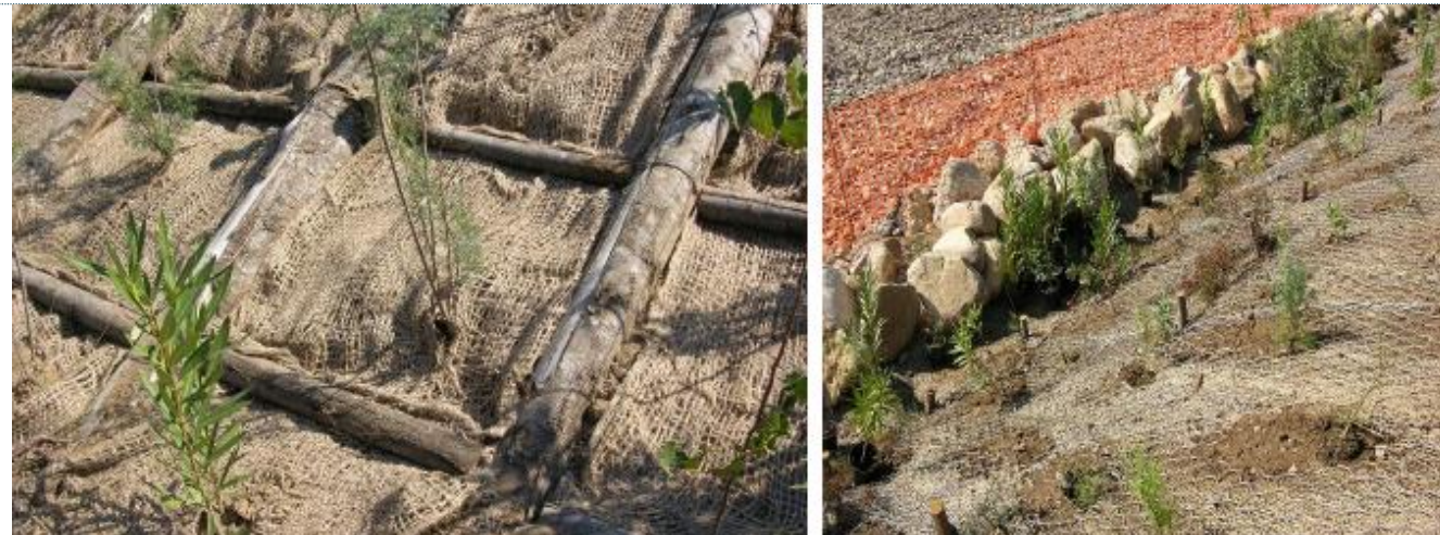
Foto 3 – Esempi di interventi di consolidamento delle rive con tecniche di ingegneria naturalistica (piantumazione in grate di legno a sinistra e piantumazione con plantule radicate e talee) (Angelini P., et al., 2009)
